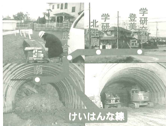
■閑静な住宅街で山岳トンネルを掘削 —けいはんな線 東生駒トンネル、北大和トンネル—
