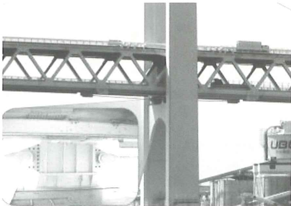
■東神戸大橋に設置されたダンパー
